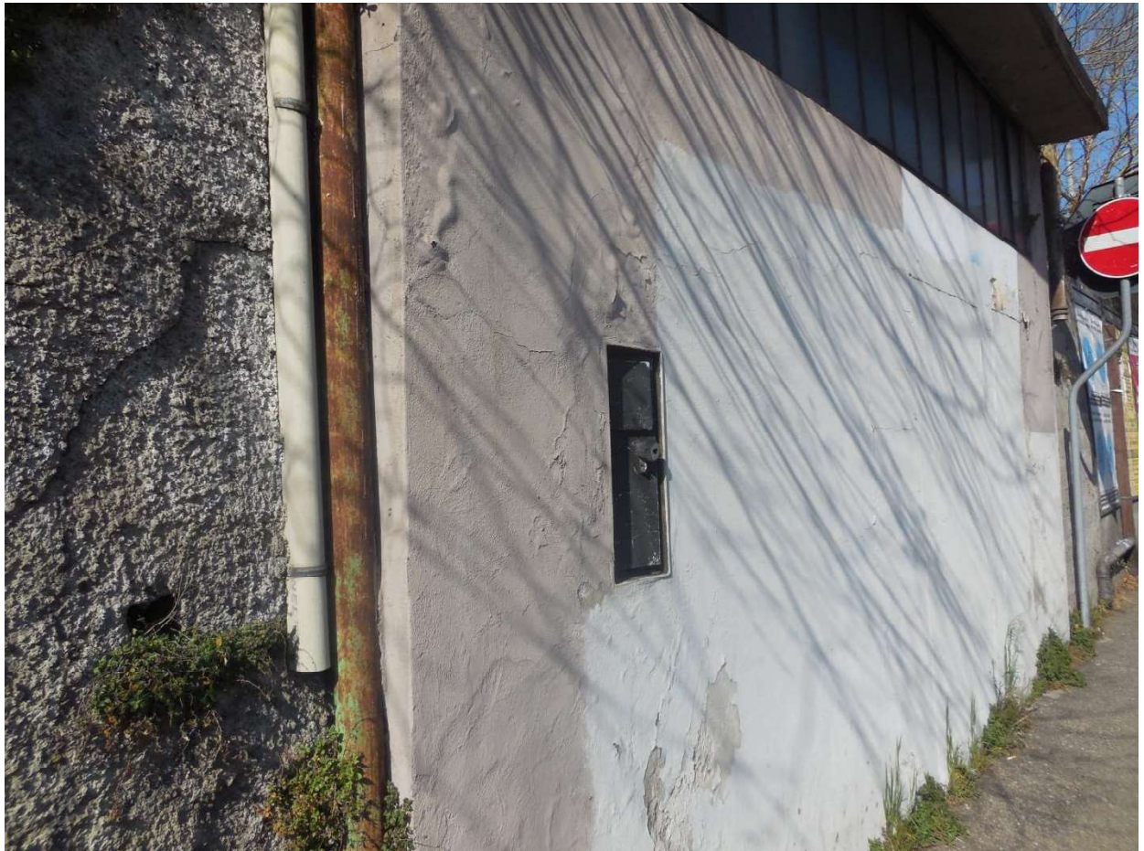
Alloggiamento contatore esistente
