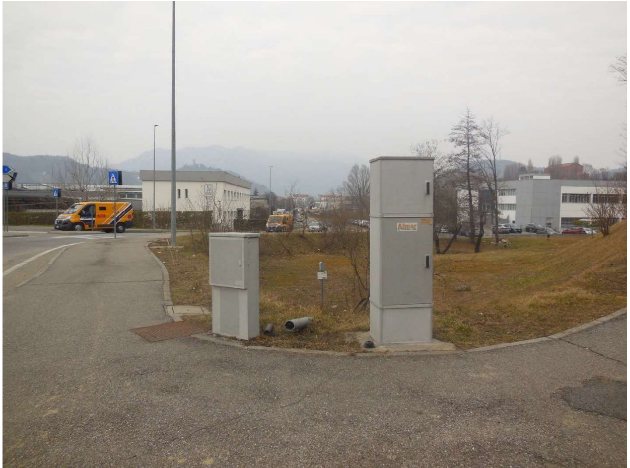
Localizzazione del nuovo contatore per la fornitura di energia elettrica
